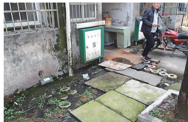
▲粪水溢出,居民只好铺砖块和木板通行 记者 贺天鸿 摄
