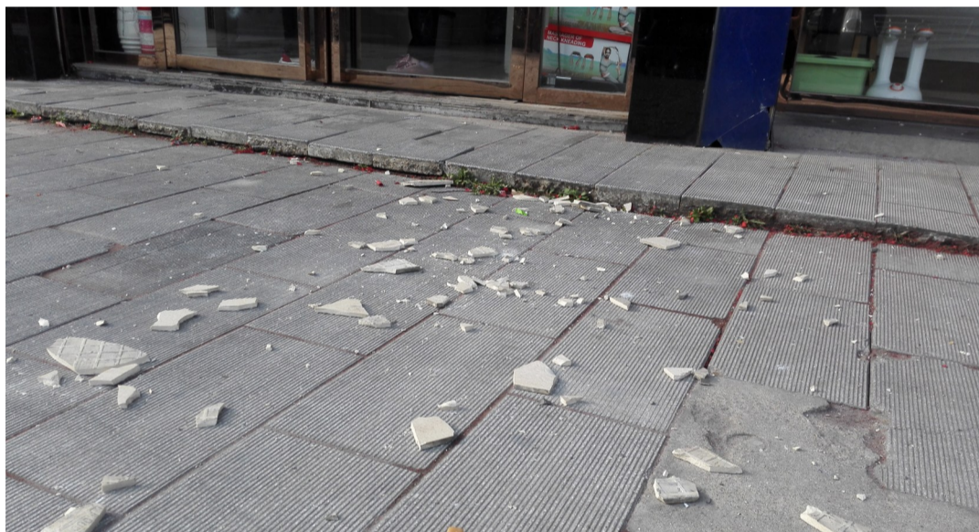
▲百益大厦外墙上脱落的瓷砖散落一地 记者 何春林 摄
