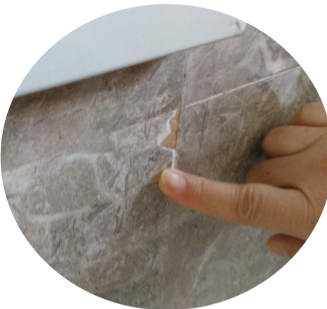
▲尹女士家卫生间墙壁瓷片出现破损 记者 姚时美 摄
