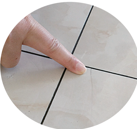
▲客厅地面瓷片出现裂缝 记者 姚时美 摄
