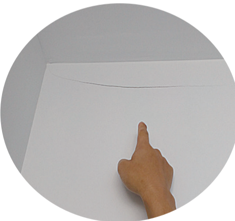
▲客厅墙壁出现裂缝 记者 姚时美 摄
