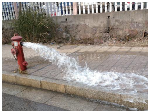
▲消防栓被打开,自来水白白流失 记者 姚时美 摄
