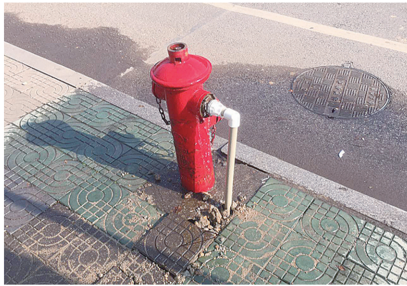
▲消防栓外接的管道一直漏水 记者 贺天鸿 摄
