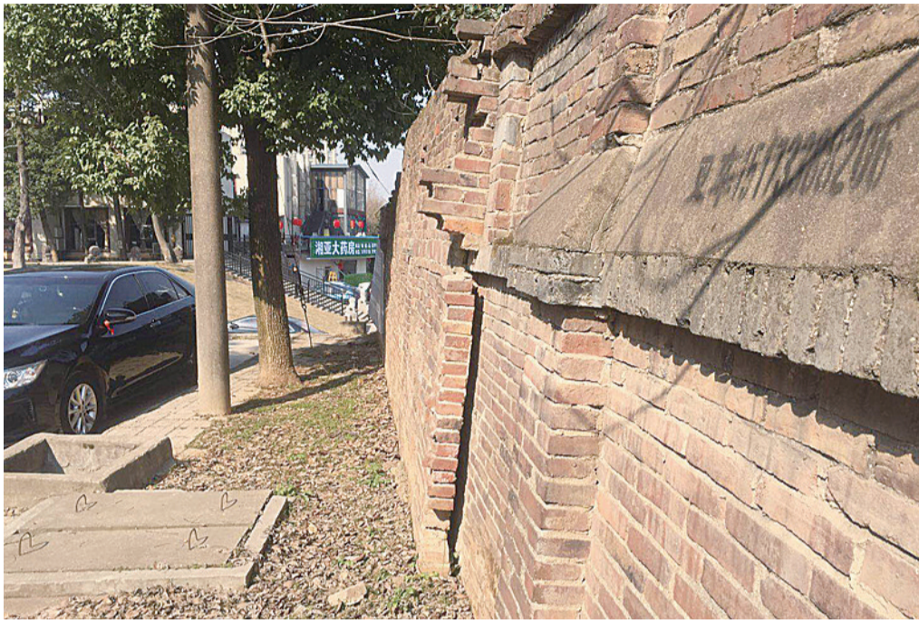
▲棉纺厂外墙倾斜且开裂 记者 贺天鸿 摄
