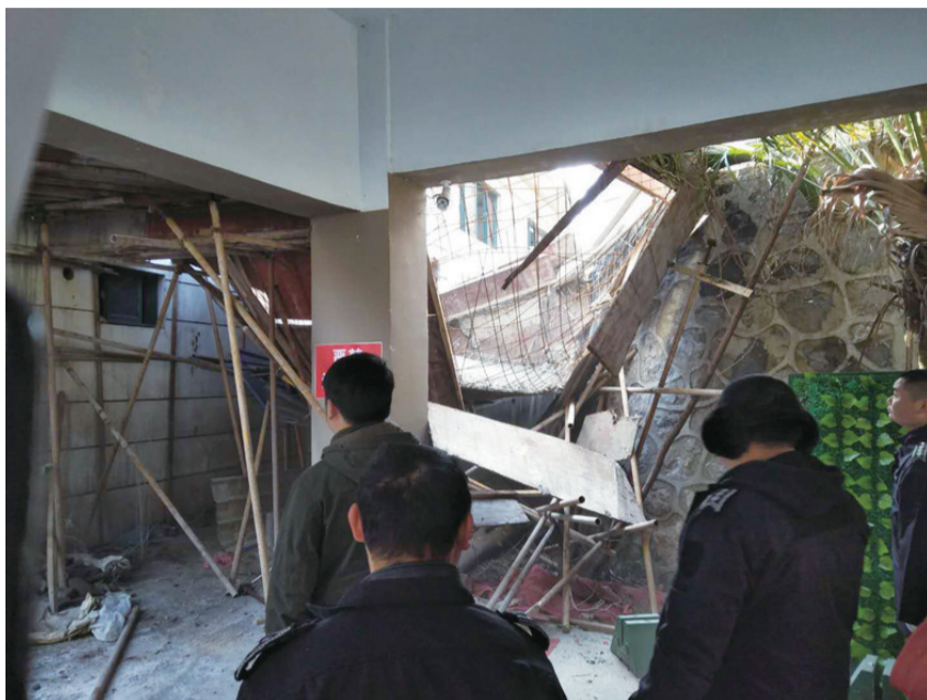
▲执法人员正在查看坍塌现场 记者 陈驰 摄
