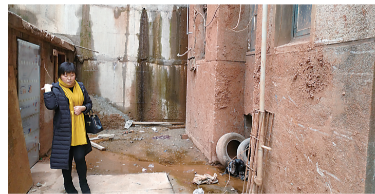
▲护坡垮塌后,墙上留下的泥土清晰可见 记者 姚时美 摄
