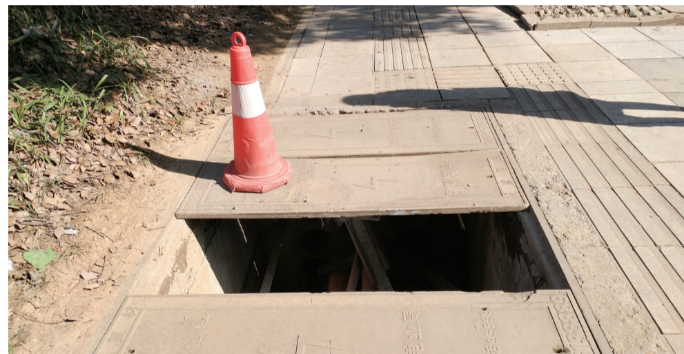
▲井盖缺失,旁边放了一个锥筒 记者 姚时美 摄
