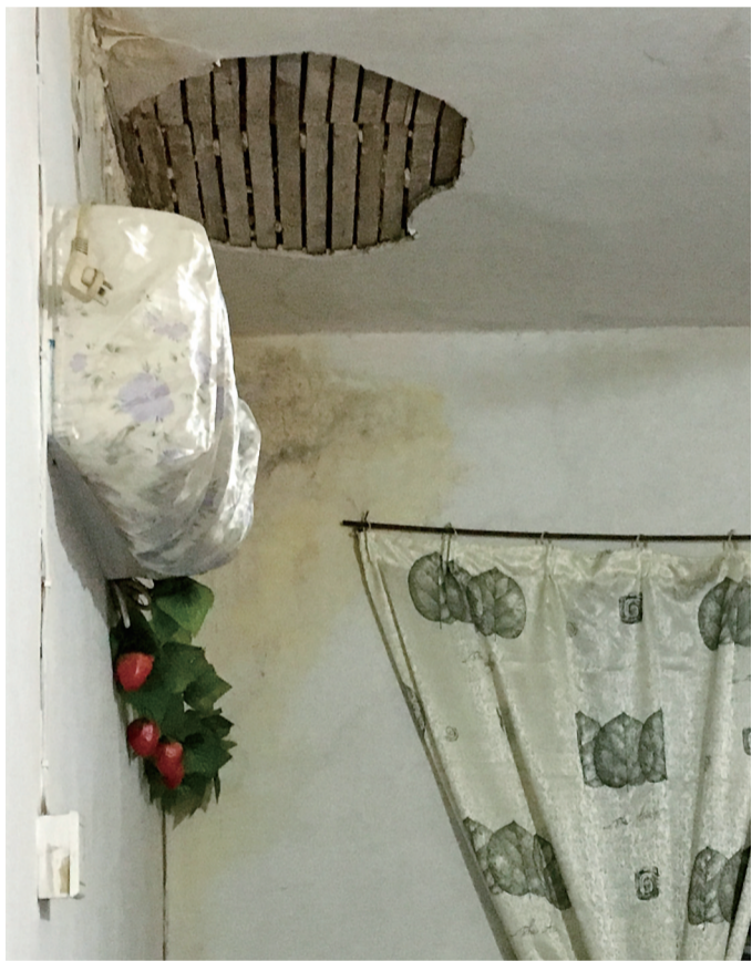
▲二十三冶二公司棚改项目中,一些房屋的天花板已掉落 记者 戴凇 摄
