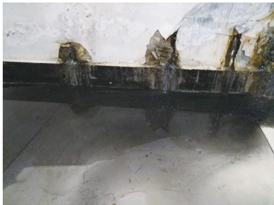
▲赵女士门面地下,墙壁渗出黑色污水 记者 姚时美 摄
