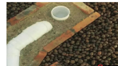
▲泥工回填厕所用陶粒回填,砌砖保护排水管,陶粒质量轻不会导致楼板产生压力,还能吸潮。
