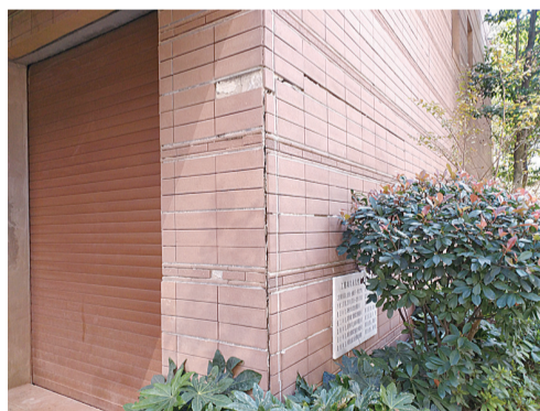
▲图片左侧为新开的后门,边上的外墙出现裂缝,部分瓷片脱落 记者 姚时美 摄
