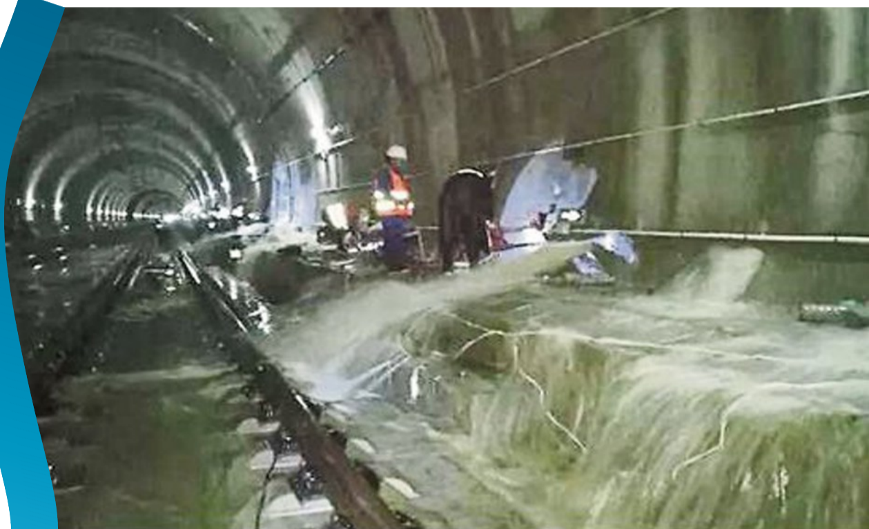
▲沪昆高铁贵州段隧道出现严重渗水(微博截图)
