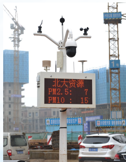
▲芦淞区天池项目工地上安装的扬尘监控设施 记者 谭清云 摄
