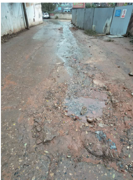
▲路面坑洼，给周边居民出行带来不便 记者 陈驰 摄
