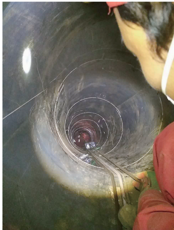
▲修大型供水主管不需对马路“开膛破肚”,技术人员可直接在管内操作 通讯员 供图
