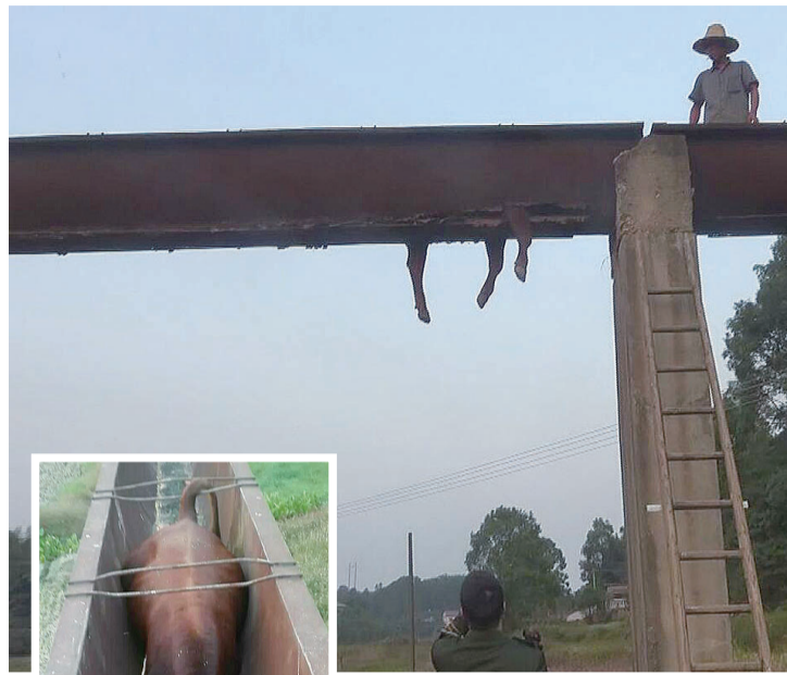
▲黄牛将渡槽底部铁皮踩穿,导致被困 消防供图
