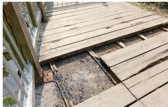
▲石子湖公园,木栈道损坏严重 记者 谢慧 摄
