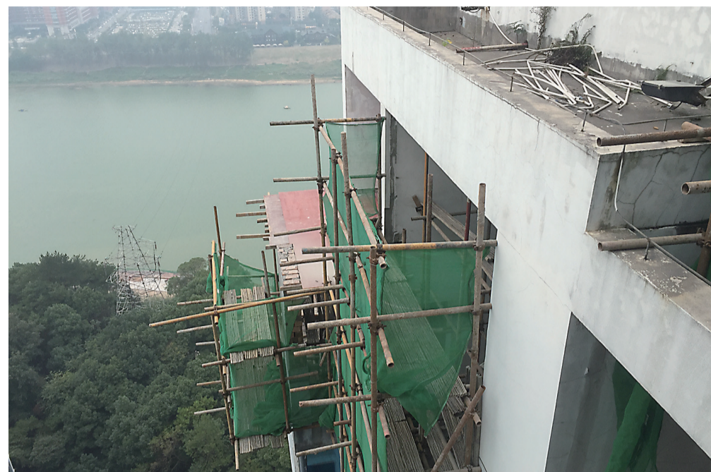
▲山水国际小区7-3001业主家外墙已被敲掉,并架设脚手架 记者 贺天鸿 摄
