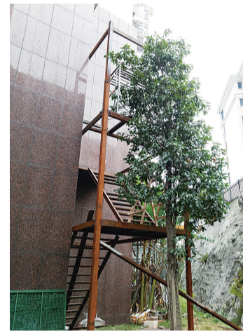
►枫溪花园小区,楼栋边建梯子已停工 记者 谢慧 摄
