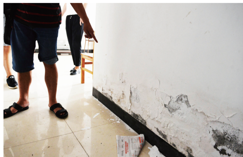
▲刘女士家的墙壁上有渗水的痕迹,墙皮部分起鼓脱落 记者 谢慧 摄
