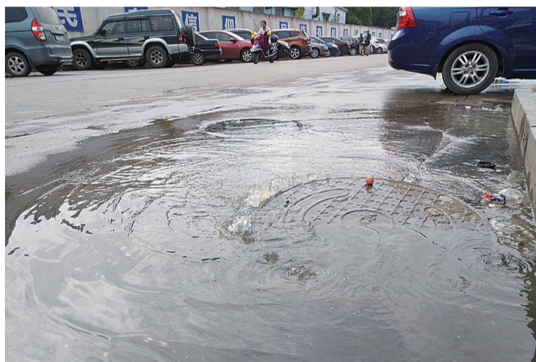
▲昨日,幸福村小区外的马路上,井盖处正在冒水 记者 谢慧 摄
