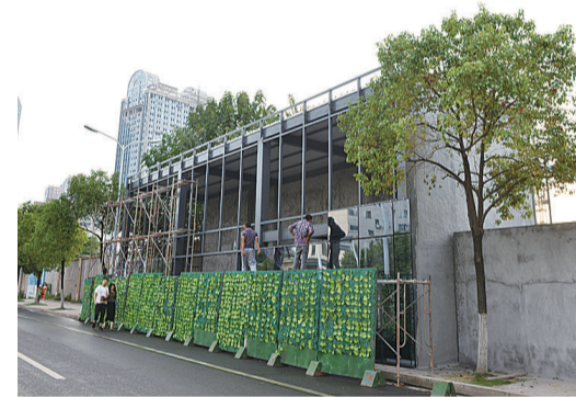
▲昨日，芦淞大桥河西桥头人行道上，工人正在施工 记者 谢慧 摄
