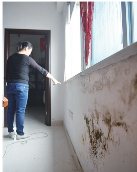
▲因为渗水太久,冯女士家墙壁已发黑 记者 谢慧 摄
