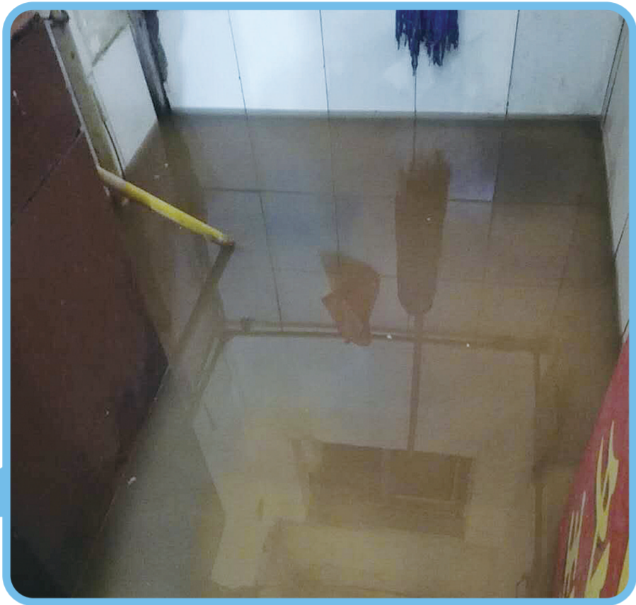
▲商铺的洗手间里涌出来的污水 受访者 供图
