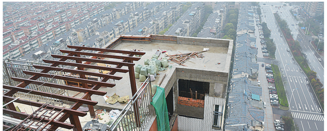
▲湘江名都2栋,一业主在楼顶加盖的房屋 记者 谢慧 摄
