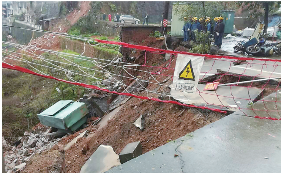
▲护坡坍塌,变配电箱滑落损坏导致小区停电 记者 何春林 摄
