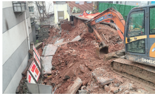
▲市政部门正在垮塌区域抢险 记者 贺天鸿 摄
