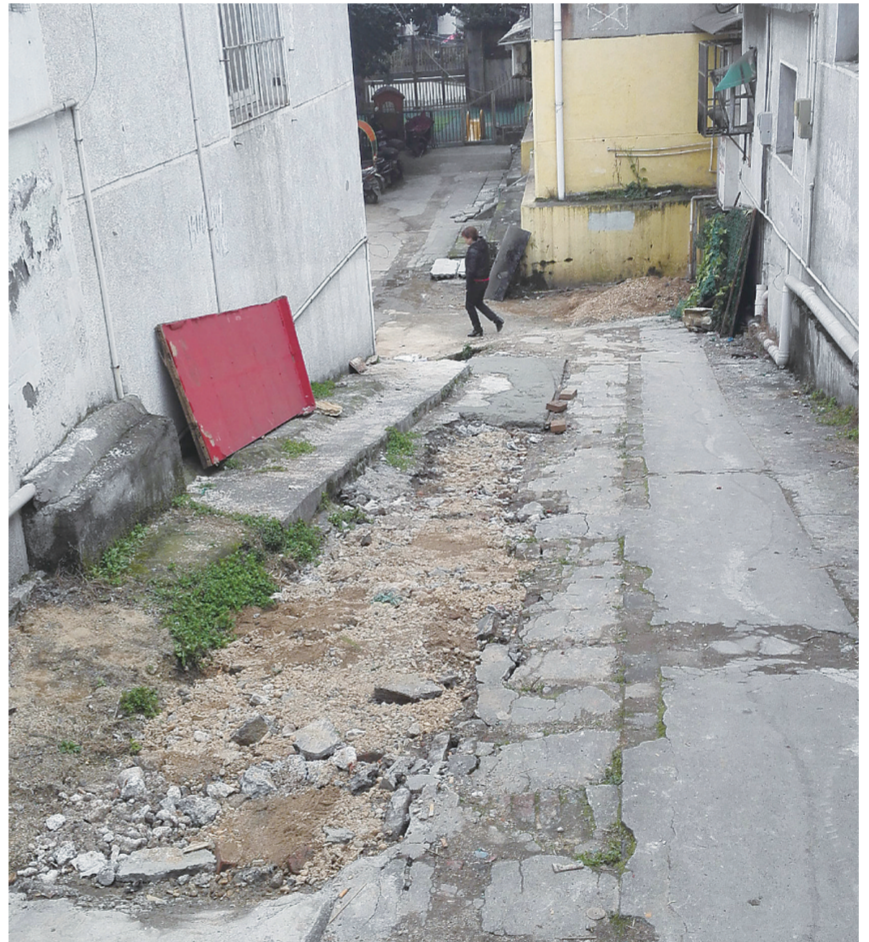
▲小区门口的路被挖烂后,居民出行很不方便 记者 旷昆红 摄
