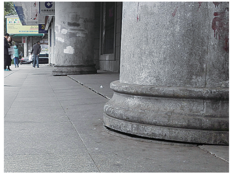
▲原本支撑地面的柱子出现部分悬空 记者 谢慧 摄
