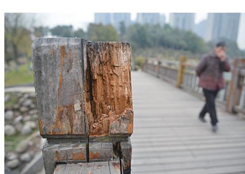
▲腐烂的木桥栏杆
