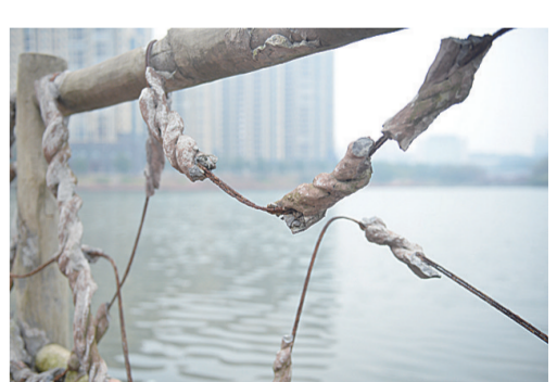
▲护栏上裸露的钢筋 记者 谢慧/图
