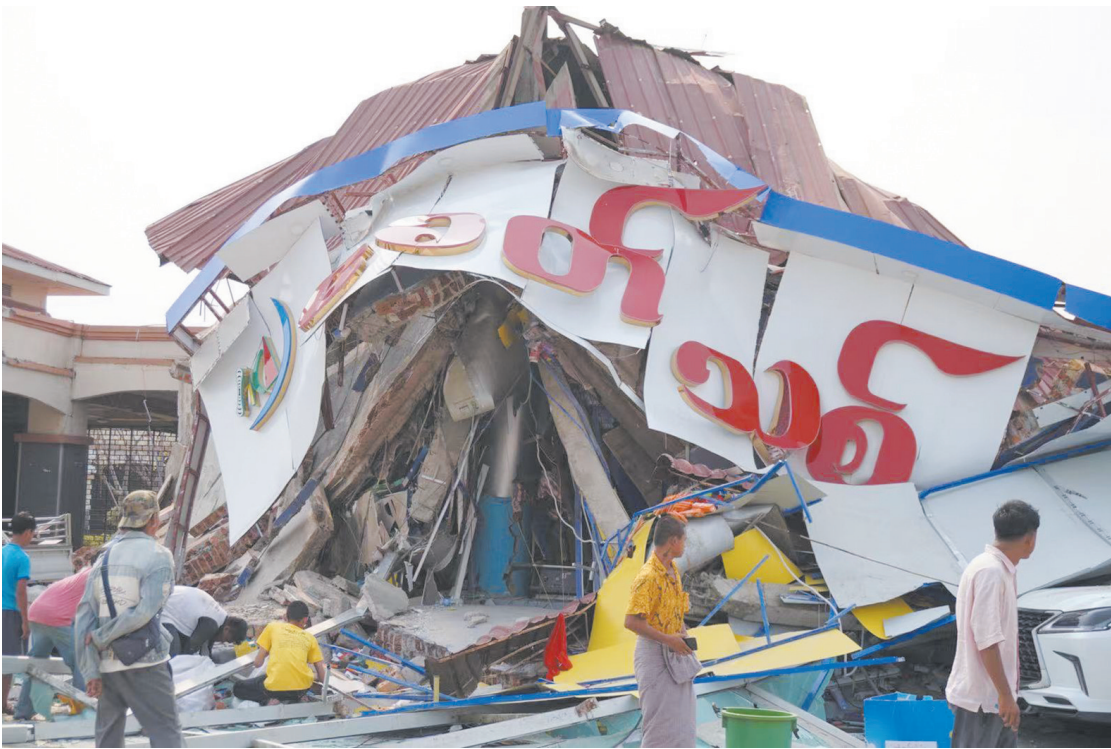
3月28日在缅甸内比都拍摄的地震后受损的建筑。
