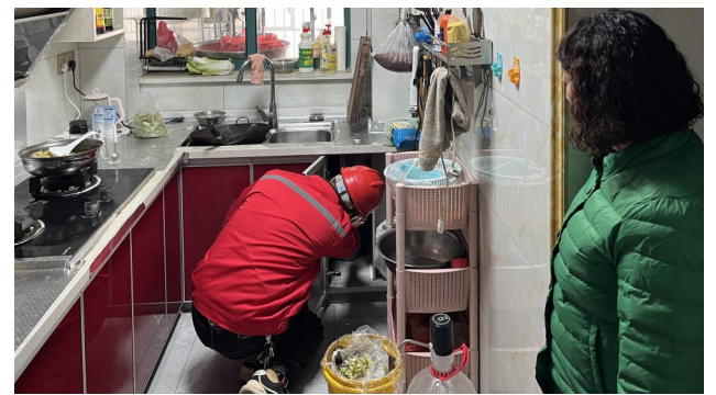
中油燃气巡检员入户对家用燃气设施进行全面检查。
