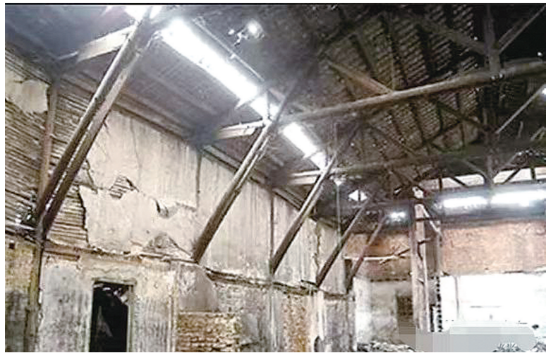
鲁班殿的断壁残垣。
