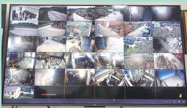
无害化处理中心视频监控系统
