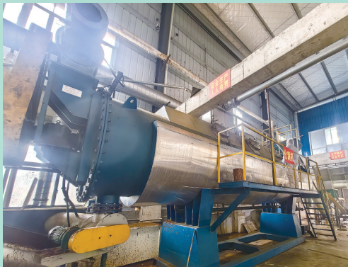
宝丰生物科技新建的高温干化无害化处理生产线
