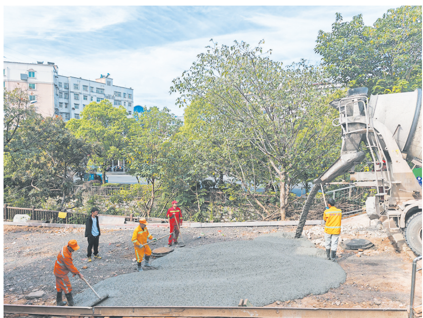
工作队修整荷塘区富家垅4号片区严重破损路面。通讯员供图
