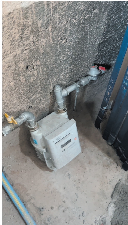
正在装修的新房内，燃气表受损。 记者/刘平 摄
