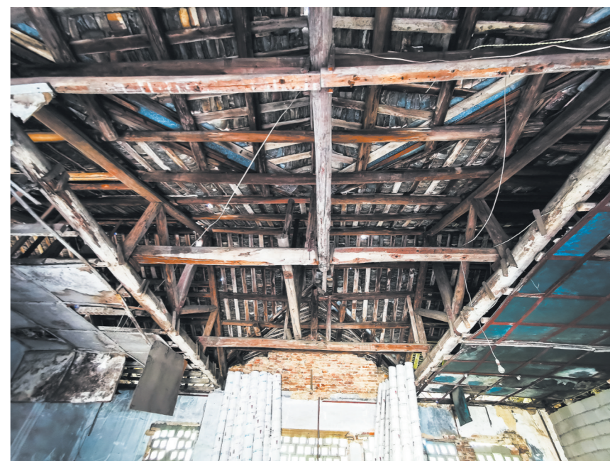
车站候车厅已经斑驳脱落的木屋架。
