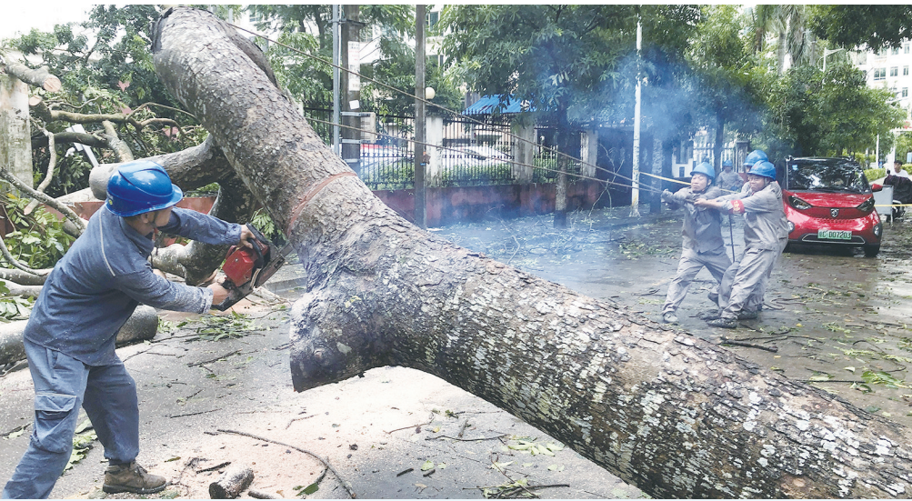
9月7日，在海南琼海万泉河家园小区，海南电网公司琼海供电公司配电网管理中心的工作人员清理树障，开展复电抢修工作。
