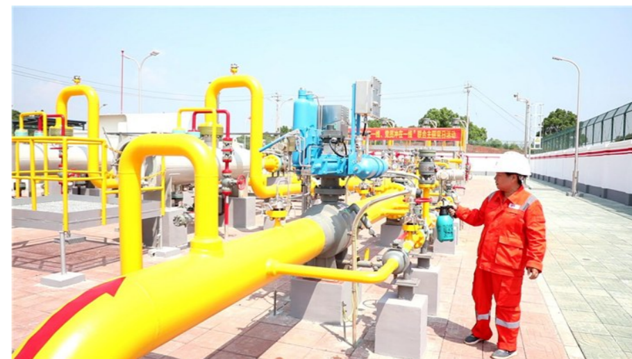
工作人员正在查看天然气管道。通讯员 供图
