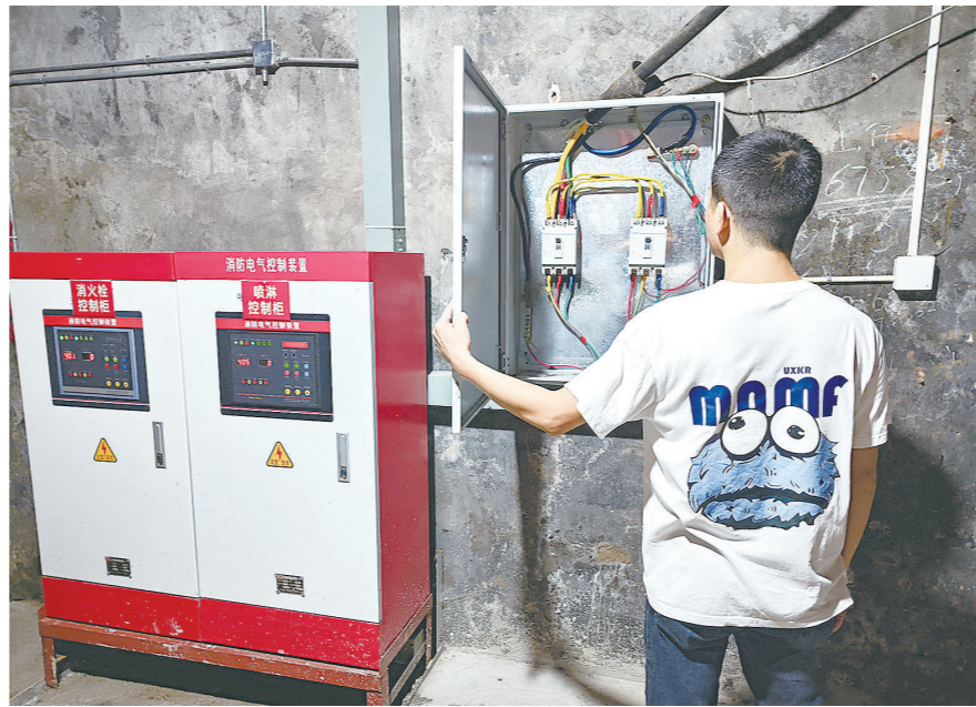
广治大厦地下一层消防控制室焕然一新。记者杨凌凌摄
