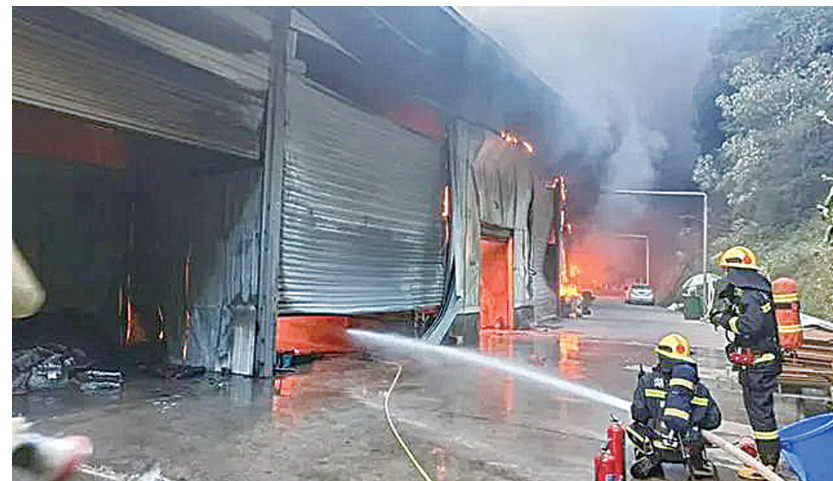
消防队员灭火现场。 通讯员供图
