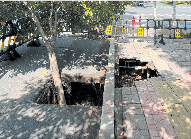
人行道上,地面塌陷。记者/刘平 摄
