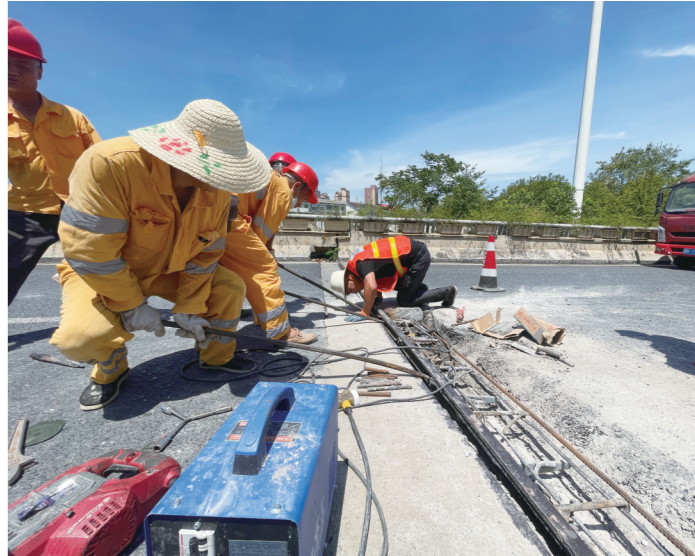
红旗立交桥上，市市政中心养护队员修复伸缩缝。记者/伍靖雯 摄
