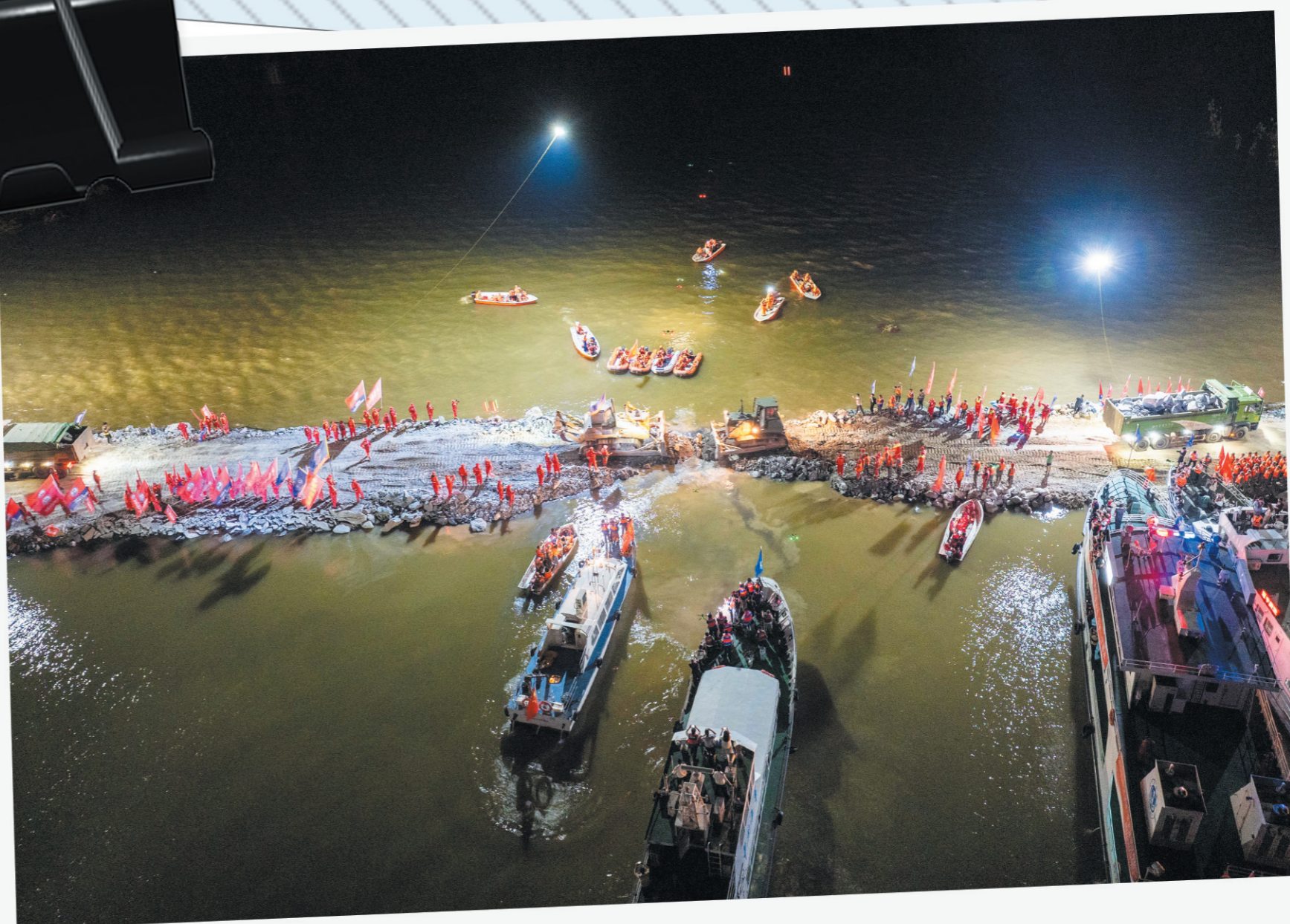
这是7月8日晚拍摄的团洲垸洞庭湖大堤决口封堵现场(无人机照片)。新华社记者陈思汗摄
