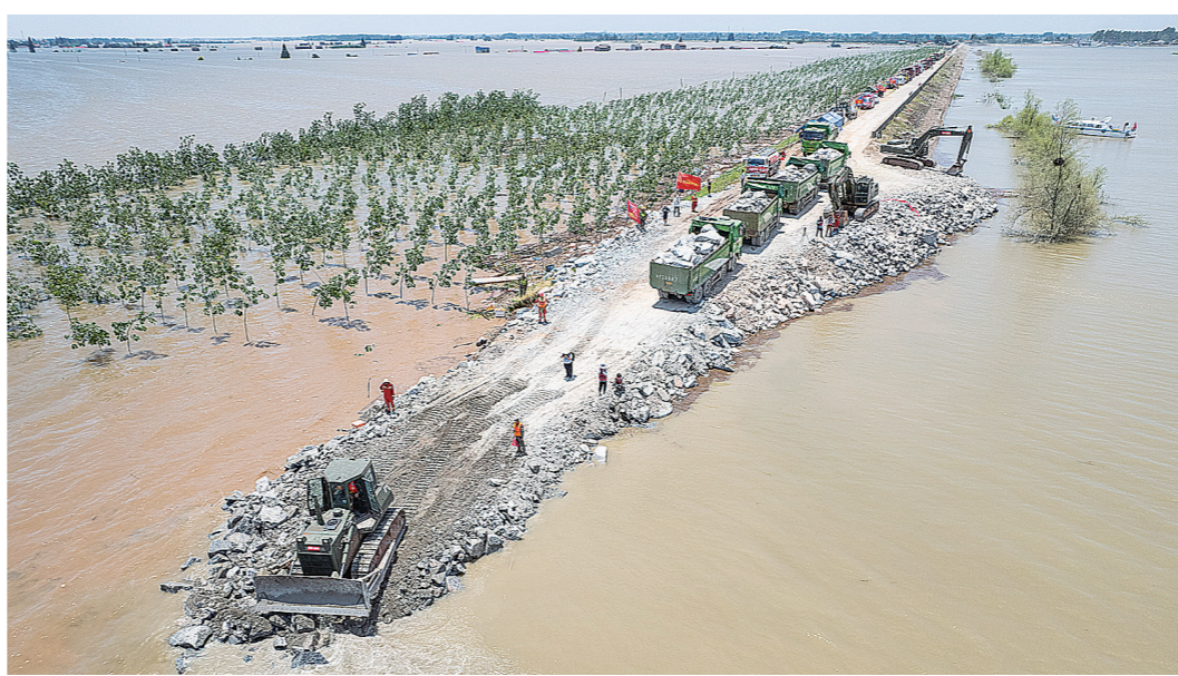
7月7日,岳阳市华容县团洲垸洞庭湖大堤决口现场,抢险队伍在进行堵口作业。 新华社发
