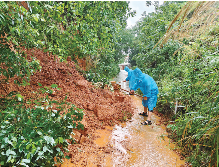
湘江村村干部与村民一起清理塌方的护坡。记者/杨凌凌 摄
