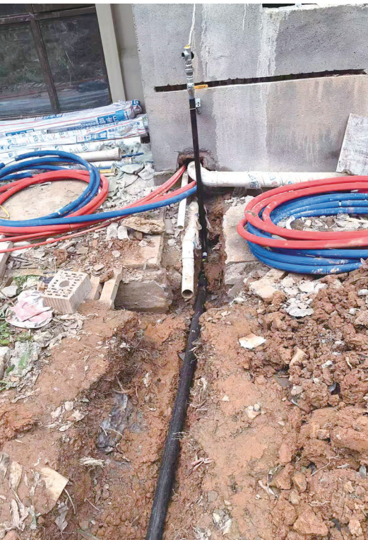
芦淞区翡翠公园被破坏的燃气管道现场。受访单位供图
