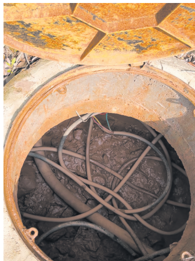
电力井，电缆留有泥水浸泡痕迹。 记者/刘平 摄
